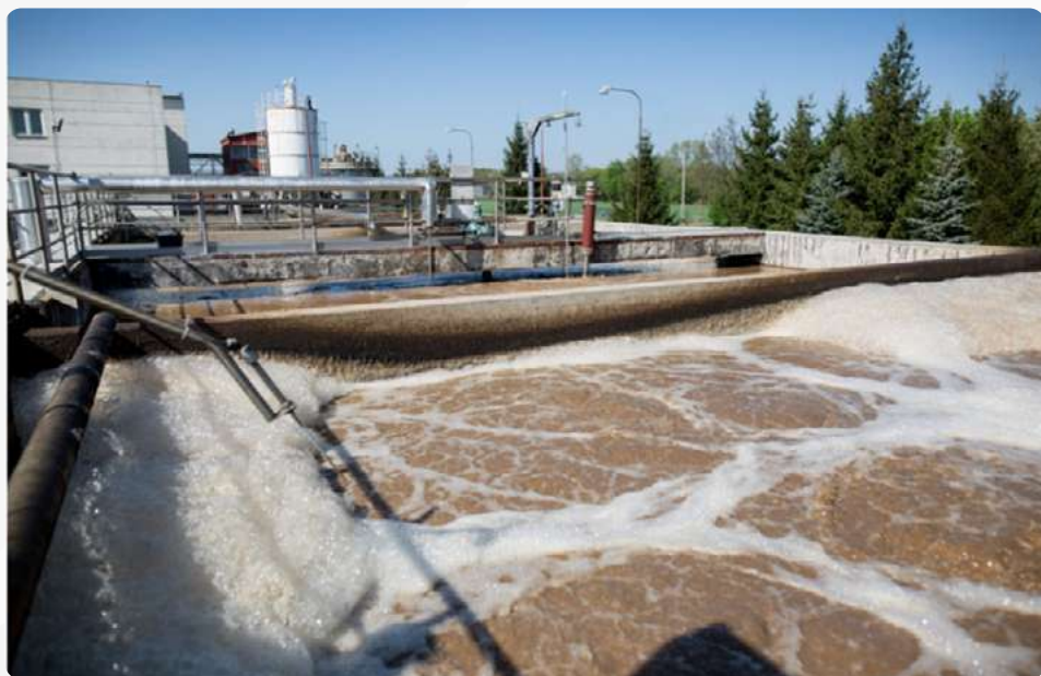
Figura 5. Imatge d'un reactor nitrificació-desnitrificació.
